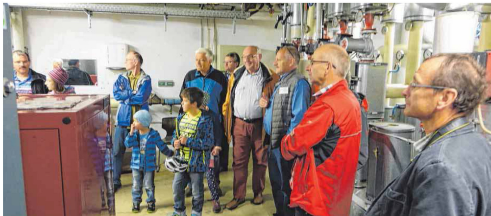
Nur ein leise schnurrender roter Kasten, aber sehr effektiv: Auch das Blockheizkraftwerk im Gymnasium wurde von der Besuchergruppe inspiziert.
